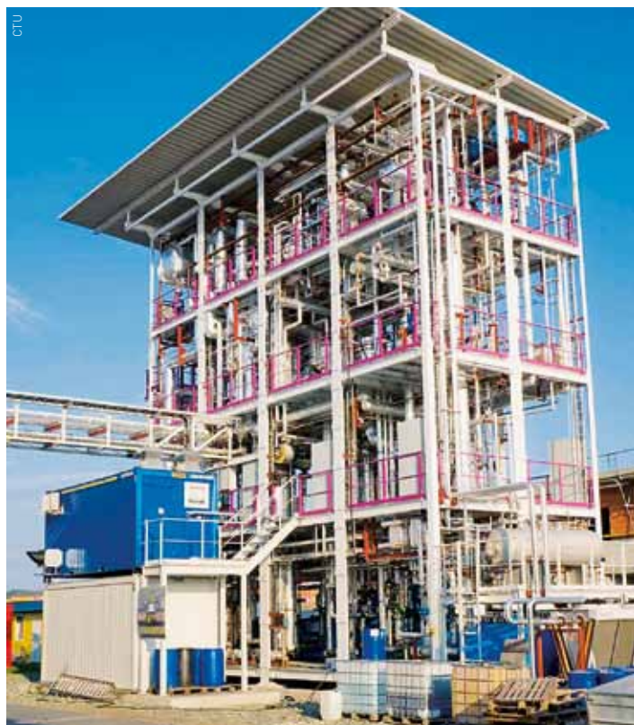
Pilotanlage zur Reinigung, Methanisierung von Holzgas mit anschliessender Aufbereitung zu synthetischem Erdgas (SNG) in Güssing, Österreich.
